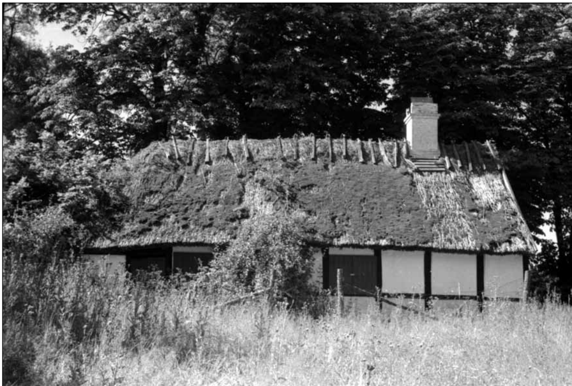
Skomagerhus, Bøgeholmhus, Gamle Anes Hus, Mor Anes Hus, Fru Heibergs Hus, i dag bare Anes Hus og måske flere andre navne. Huset ved Bøgeholmsøen blev kendt gennem Johanne Louise Heibergs erindringer fra 1847, hvor hun under et ophold på Hellebæk Kro mødte Gamle Ane. JU 1952
